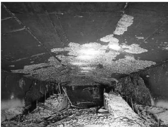
图 4 边跨现浇段右侧箱室烧伤、熏黑
