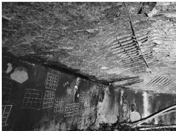
图 5 顶板烧伤剥落露筋
