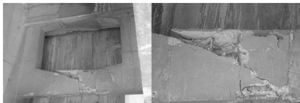
图6 引桥侧T梁端横隔板受损状况
