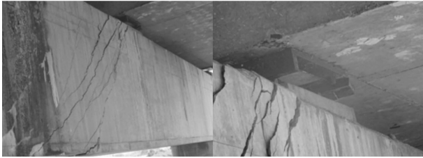
图3 盖梁受损状况
