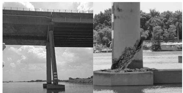
图2 墩柱受损状况
