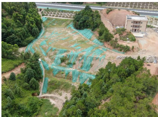
K50+350 右侧弃渣场
