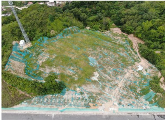
K71+150 右侧弃渣场
